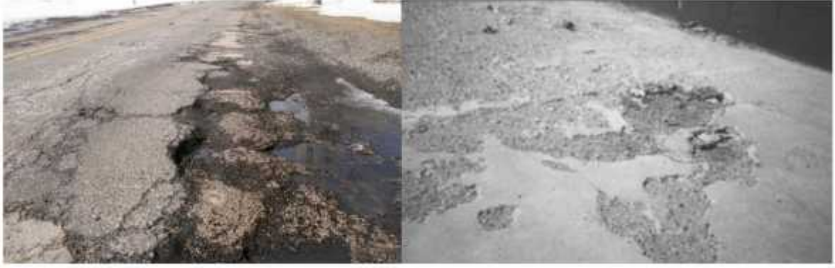
Resim 9 Donma-çözülme döngüsünün yollarda ve köprü döşemelerinde meydana getirdiği hasara örnek
