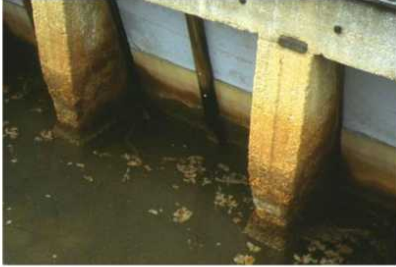
Resim 10 Kimyasal atağın neden olduğu beton hasarına örnek
